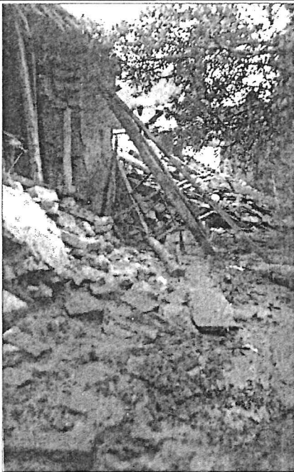
Pobořená zadní část domu p. Čeňka Štěrby č. 37
